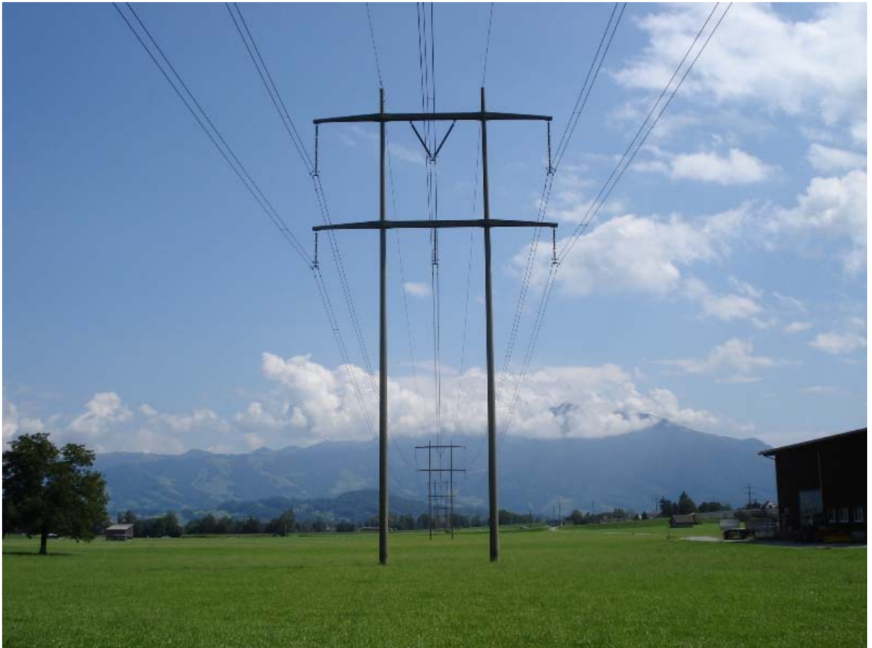
Abb. 4: Leitung auf Betonmasten. Eine 220kV-Leitung auf Betonmasten.
