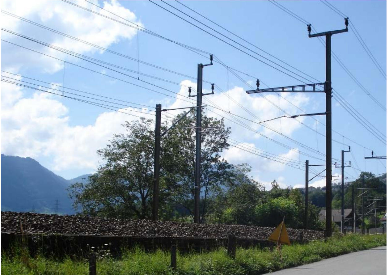
Abb. 9: Bahntrasse mit Fahrleitung. Entlang der Bahntrassees sind die Schwankungen der magnetischen Feldstärke sehr viel grösser als entlang von Hochspannungsleitungen.
