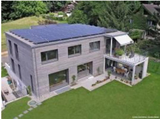
Gut: dem Schema entsprechende Anordnung der Kollektoren auf Flachdach
