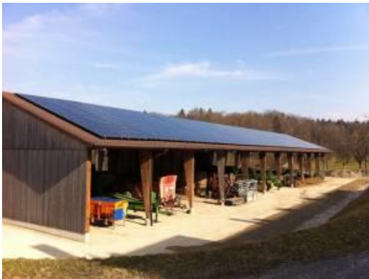
Gut: vollständige Bedeckung mit aufgesetzter Anlage und dem notwendigen Abstand zum Dachrand.
