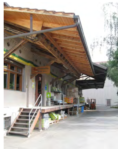
Ein Güterumschlagplatz muss überdacht, befestigt und abflusslos sein. Zusätzlich muss jederzeit Bindemittel bereit stehen.
