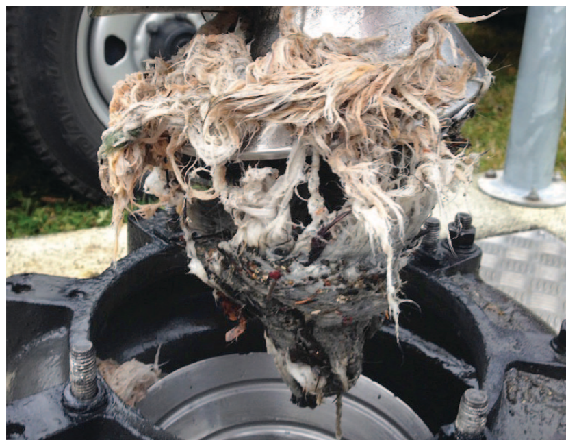
Verstopfte Pumpen, aufwändige Instandstellung.
