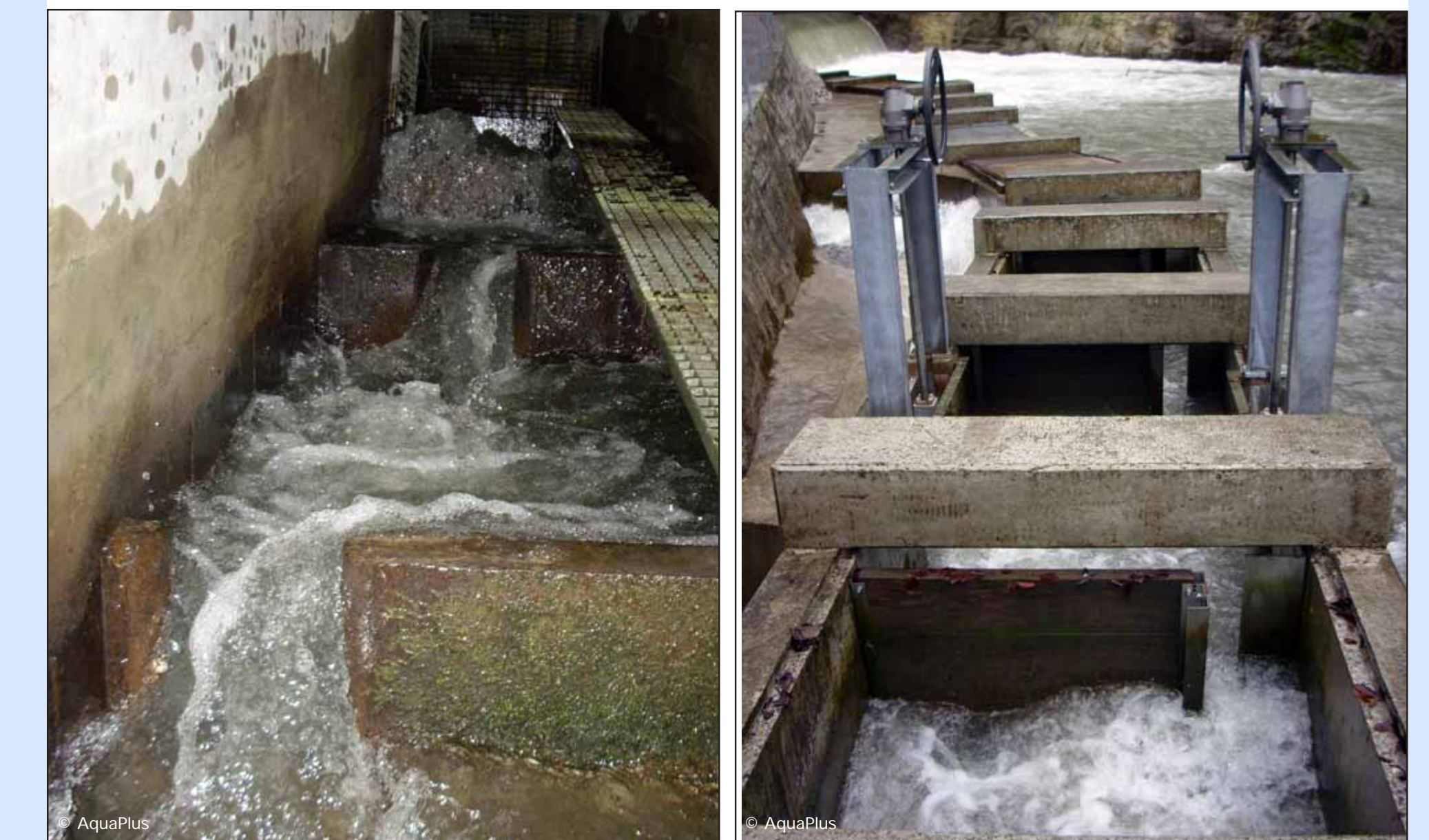
Fischtreppen beim Kraftwerk Hürlimann (links) und beim Wehr der ehemaligen Spinnerei Ibach (rechts)
