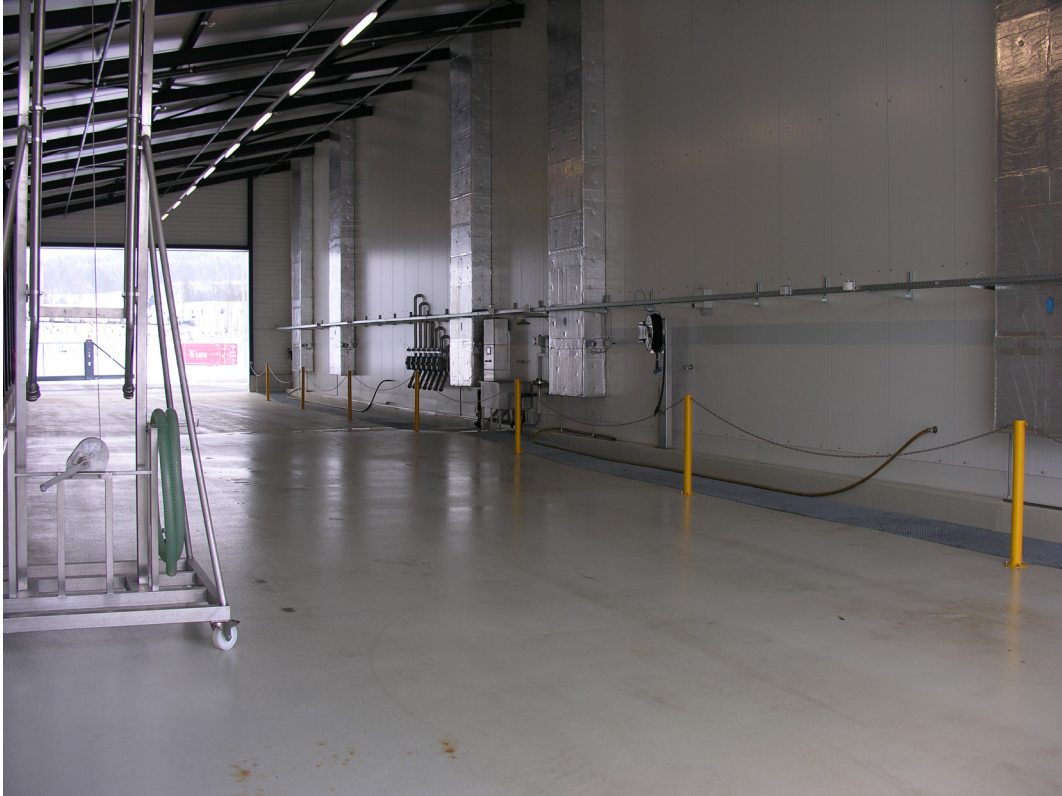
Umschlagplatz für Tankfahrzeuge mit mediumbeständigem Boden und Auffangwanne, Halag Chemie AG, Aadorf
