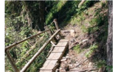
Schadhafte bauliche Vorrichtungen, welche ihre Schutzfunktion nicht mehr erfüllen, sind zu reparieren.
