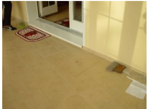
Notausstiegsschacht 60 / 80 cm mit geschlossener Abdeckung.
