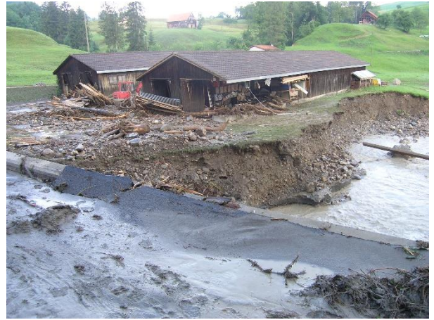
Abb. 4: Sichtbare Ufererosion nach Rückgang des Hochwassers vom Juni 2007 an der Grossbachstrasse in Gross, Bezirk Einsiedeln, Foto: AWN
