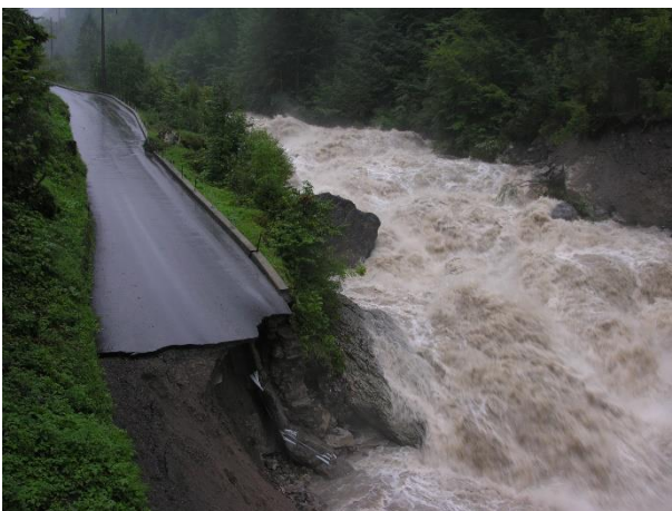
Abb. 3: Hochwasser der Muota im August 2005. Die Ufererosion zerstörte einen Teil der Strasse im Herrgottstutz im Muotathal. Foto: AWN
