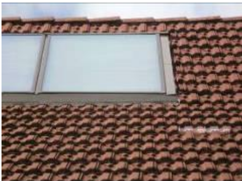
Gut: farblich gut angepasste eingebaute Anlage
