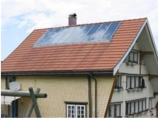
Gut: Die eingebaute Anlage ist gut integriert.
