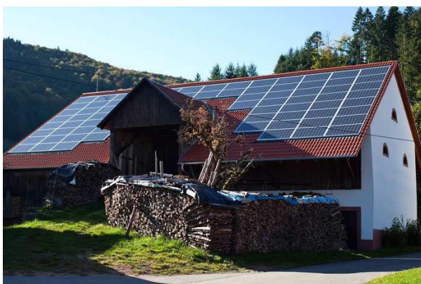
Schlecht: nicht an die Dachform angepasste Kollektorfelder
