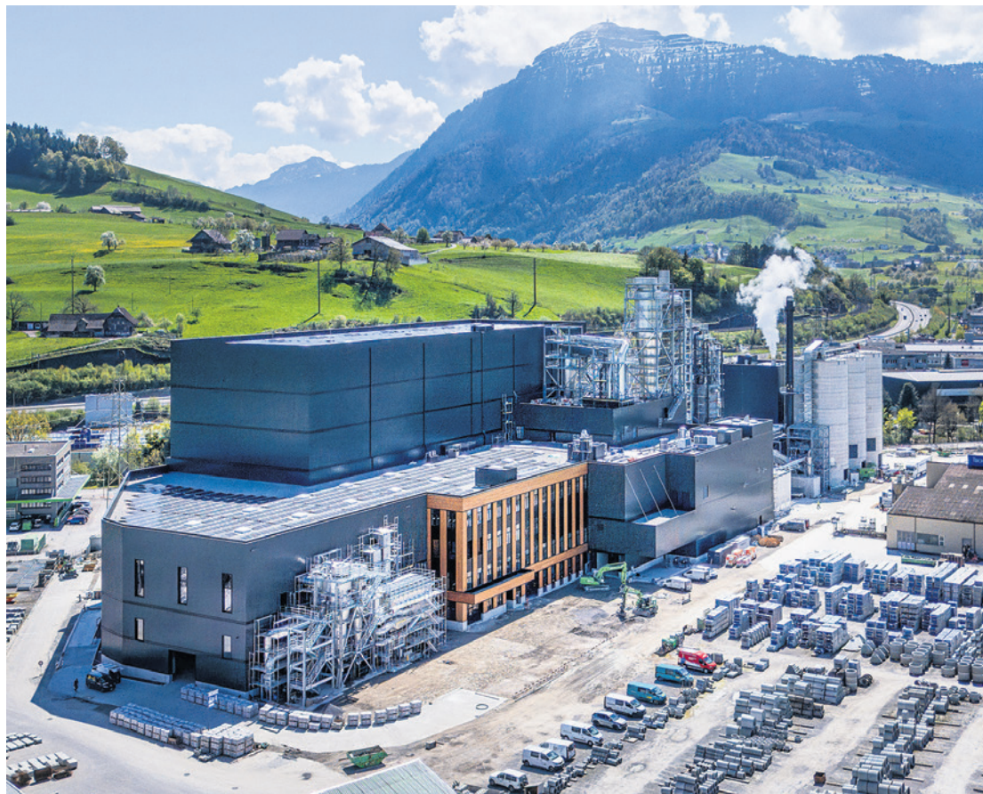
Schilliger Holz baut in Küsnacht ein Holzfaserdämmplattenwerk. Die schweizweit grösste Sägerei schafft damit rund 50 zusätzliche Arbeitsplätze vor allem in der Produktion. Bild: zvg
