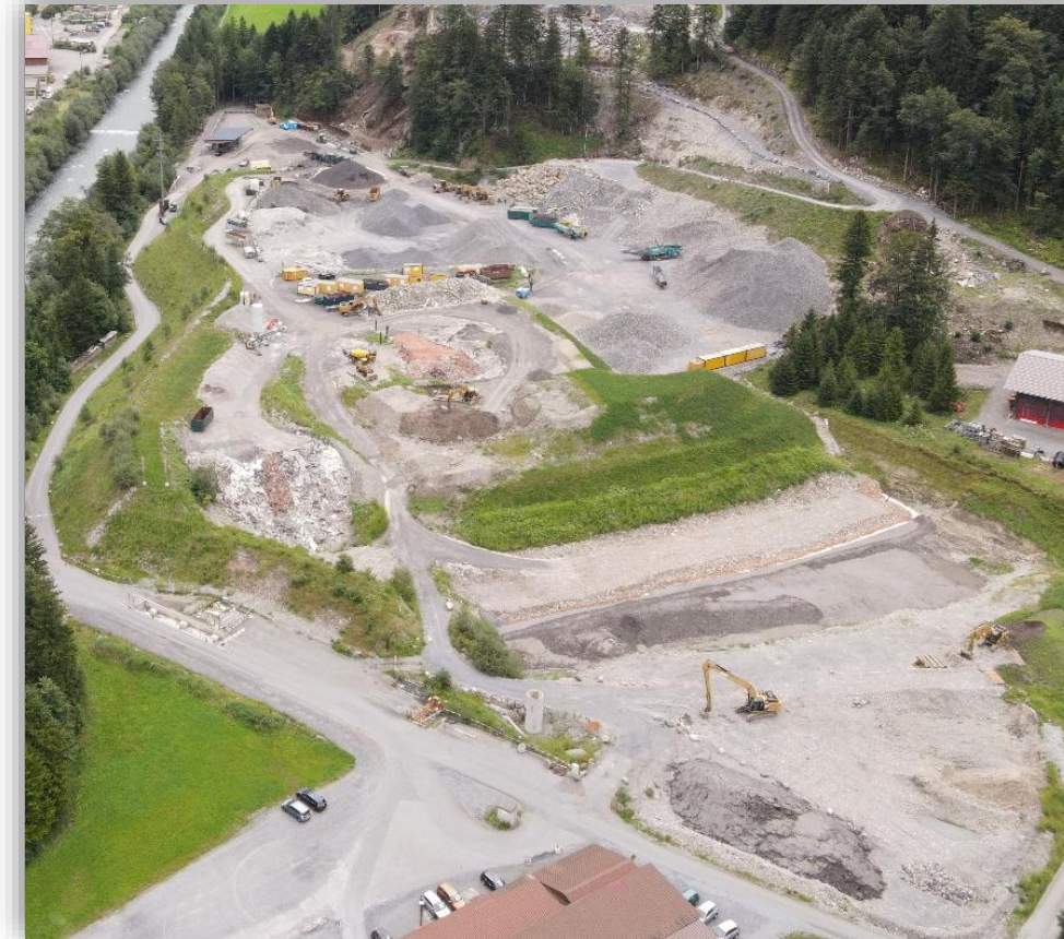
Deponie mit PFAS im Sickerwasser
